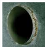
6 Monate (verzinktem Stahl) 30-40% roter Rost 60% weißer Rost
